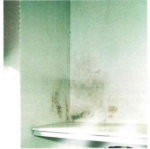
In Raumecken bilden sich gern Schimmelflächen, weil hier der Wärmedurchgang nach außen am größten und die Wandoberflächentemperatur am geringsten ist
